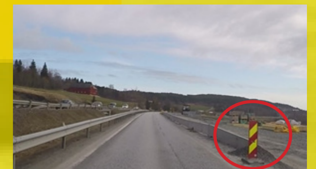
Langsgående rekkverk utan arbeidsrom. Dette er ikkje i samsvar med Handbok N301.
