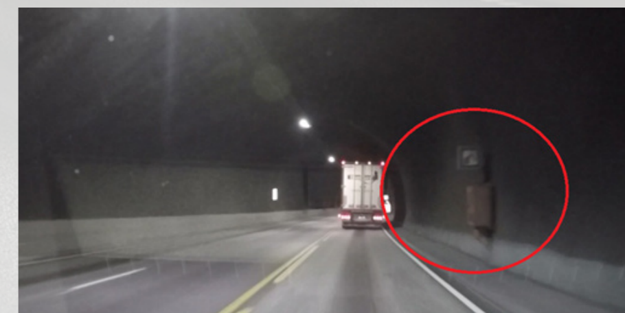
Bømlafjordtunnelen: Manglende lys i skilt over nødskap. Det er usikkert om nødskapet er i drift eller ikke. Ifølge beredskapsplan skal nødutstyr være i drift gjennom hele anleggsperioden.
