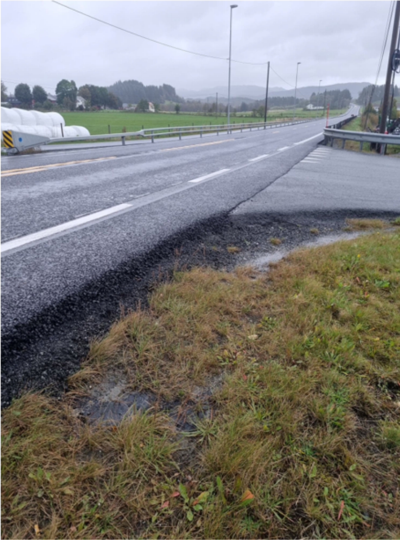
Bilde 2 - Hentet fra 01-2023 Tilstand på asfaltkant
