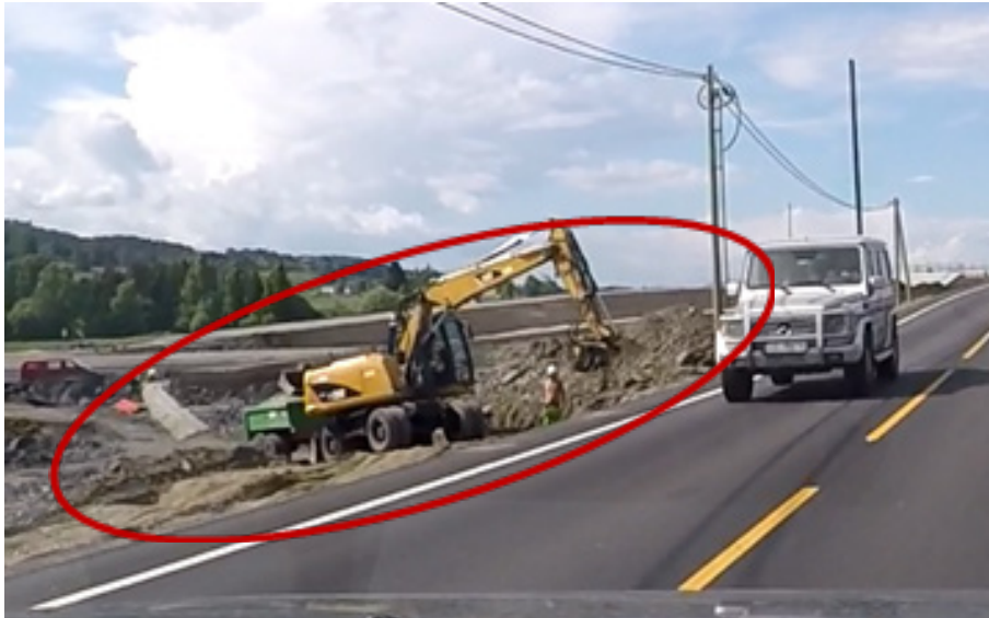
Bilde nr 1: Manglende langsgående sikring (arbeidsområde 1, Rv 4 Gran – Jaren)
