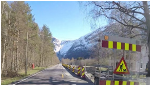
Langsgående rekkverk utan arbeidsrom. Dette er ikkje i samsvar med Handbok N301 pkt. 4.2.1.2.
