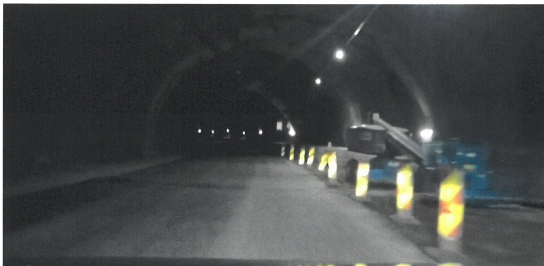
Fretheimstunnelen: Lift parkert tett inntil vegkanten. Fare for påkjørsel, ingen sikring. Fartsgrensen er 60 km/t.
