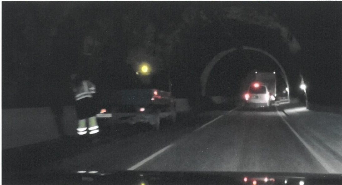
Onstatunnelen: Bildet viser pågående arbeid uten markering eller sikring av arbeidsområdet. Tunnelen er på dette tidspunktet kolonnekjørt.
