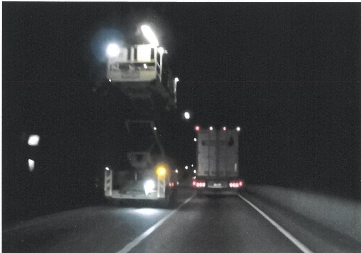
Bømlafjordstunnelen: Bildet viser lift i arbeid uten markering eller sikring. Traileren på bildet var svært nærme liften.
