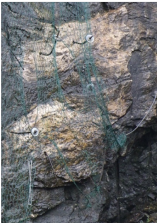
Biletet syner skadar på nett. Under inspeksjon fann Vegtilsynet at om lag 26 prosent av netta på dei undersøkte strekningane hadde skader.
