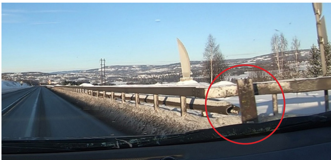
Bilde 1: Trafikkfarlig rekkverks-ende bak midlertidig sikring (70 km/t, mot fartsretning)
