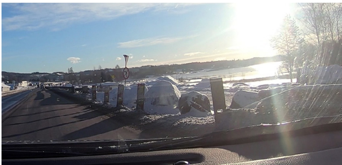
Bilde 2: Store steiner er benyttet som sikring av driftsåpning. Disse er påkjørselsfarlige element i sikkerhetssonen
