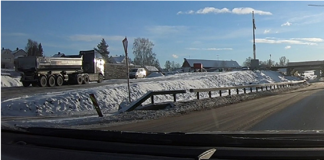
Bilde 6: Mangelfull innfesting mellom rekkverkselement
