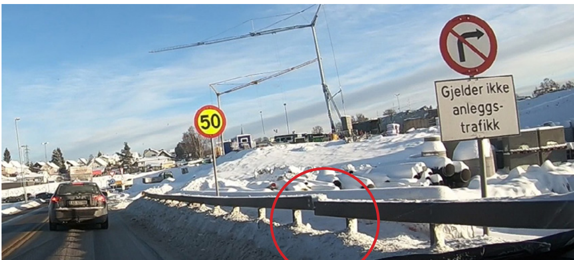
Bilde 5: Mangelfull innfesting mellom rekkverkselement. Det er observert et stort antall slike på strekningen.
