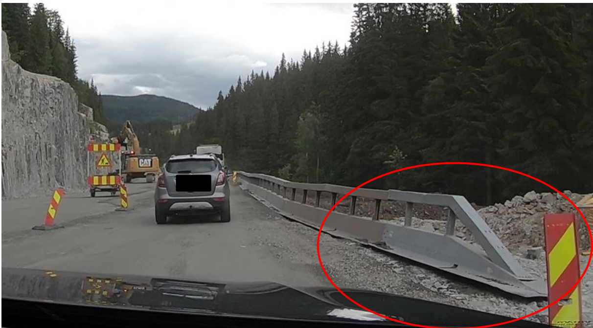
Manglende forankring av rekkverksende (E134 Åmot- Seljord)
