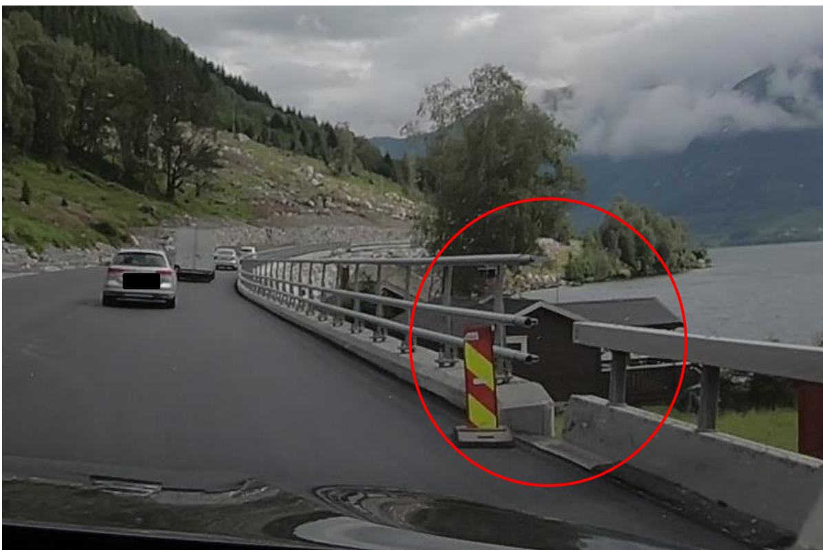
Trafikkfarlig rekkverksende (E39 Bjørset- Skei)
