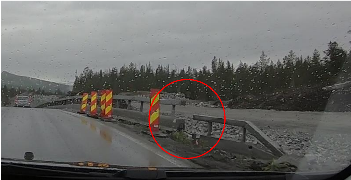
Manglende forankring mellom rekkverksende og rekkverk (E6 Helgeland)
