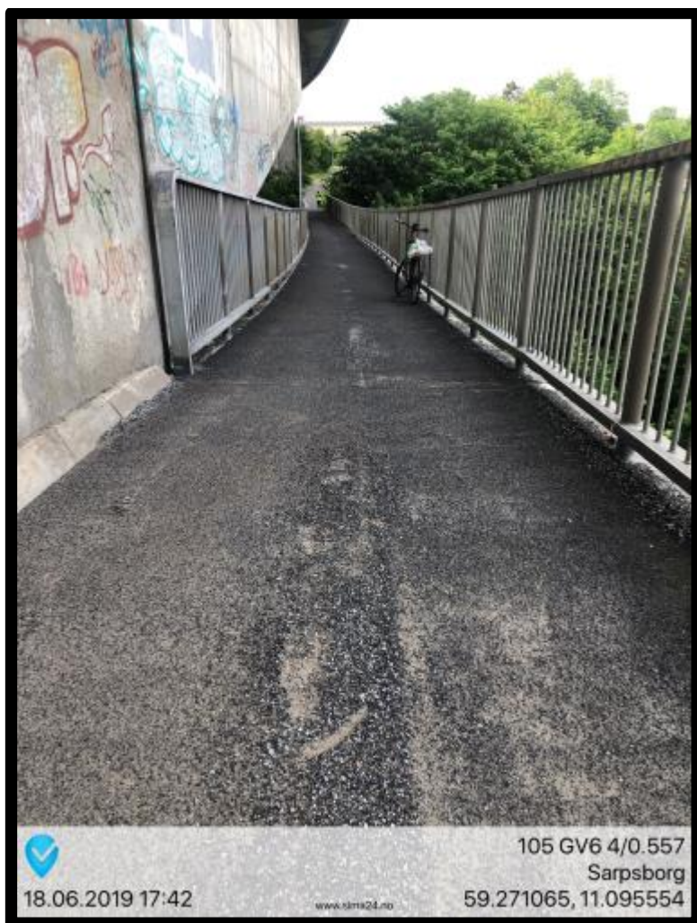
Bildet viser gang- og sykkelveg med grus i vegbana. Dette er registrert som tilstand som ikkje var i samsvar med krav til Kap. 8.2 (Renhold) Gang- og sykkelveg, sykkelveg med fortau, trapp og rampe.
