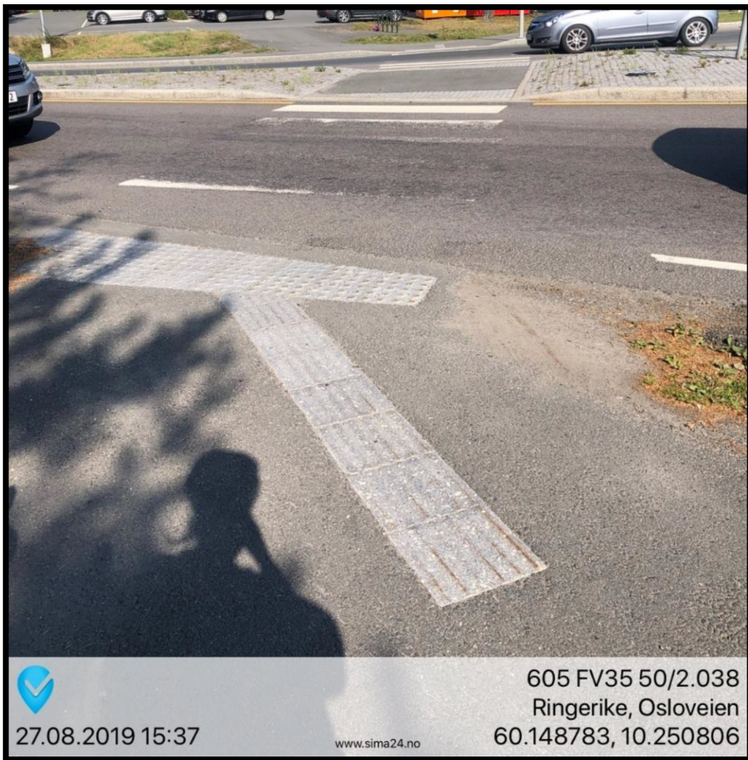
Bildet viser dårleg/manglande vegoppmerking i gangfelt. Tilstand var ikkje i samsvar med krav til kap. 5.4 Vegoppmerking
