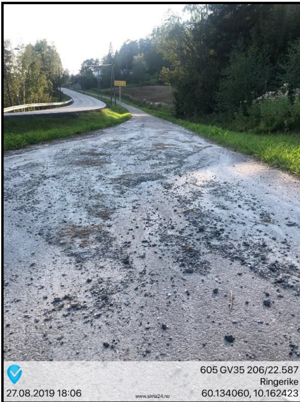
Bildet viser grus på gang- og sykkelveg. Tilstand var ikkje i samsvar med krav til Kap. 8.2 Gang- og sykkelveg, sykkelveg med fortau, fortau, trapp og rampe
