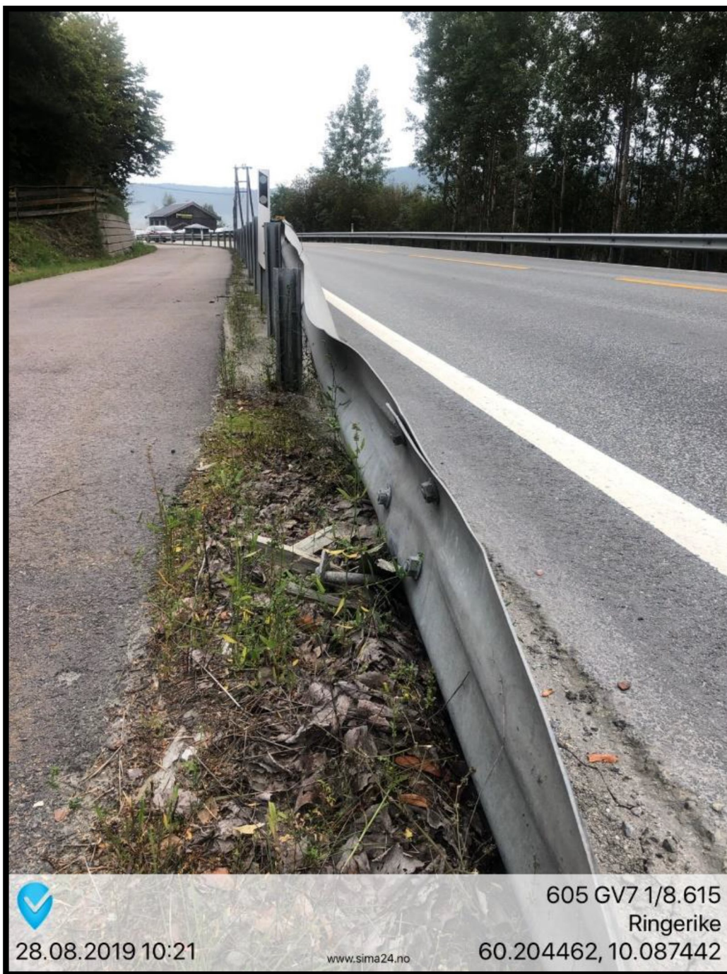
Bildet viser skada rekkverk. Tilstand var ikke i samsvar med krav til Kap. 5.15 Rekkverk
