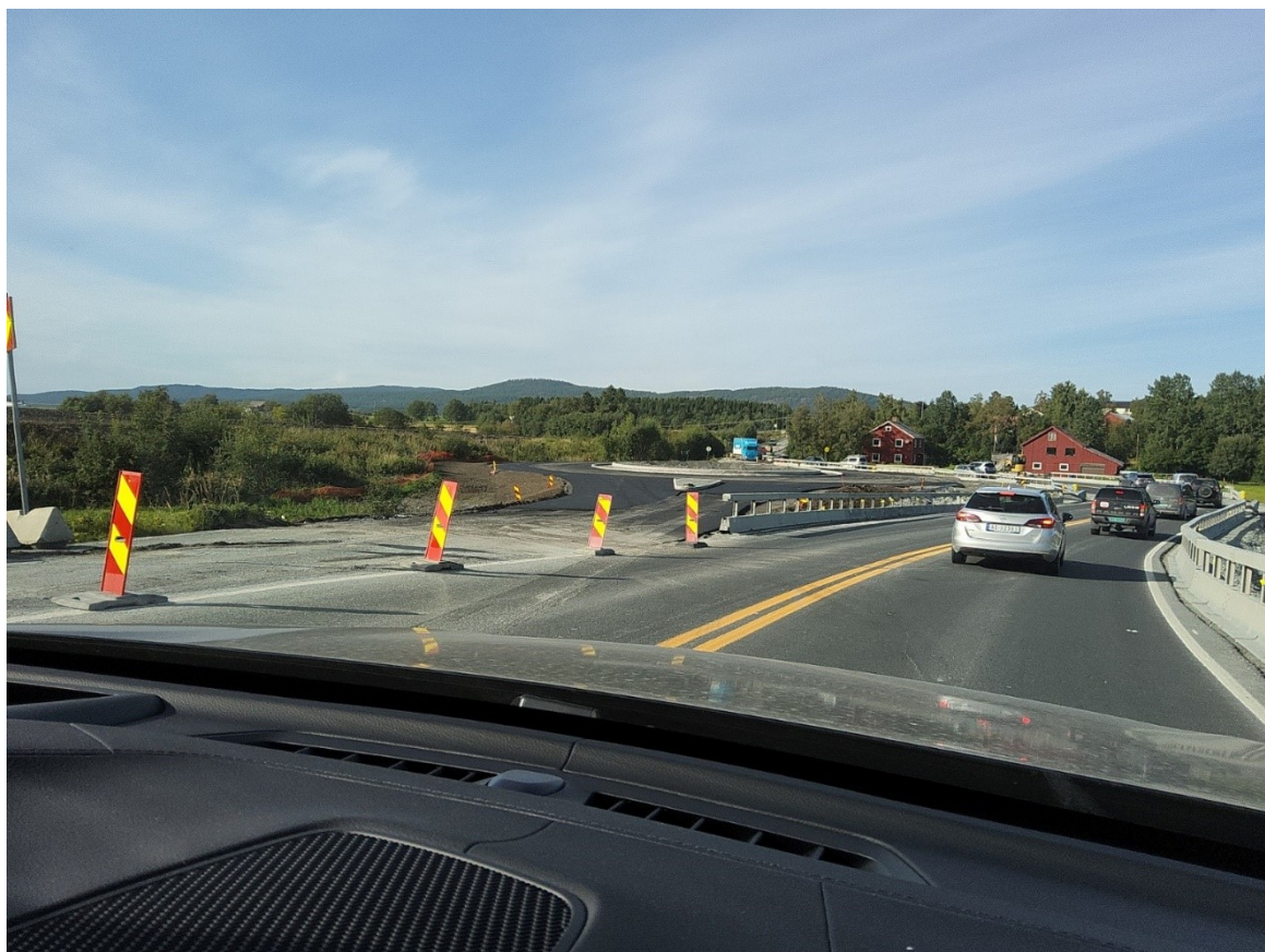
Bilde 3: Manglende rekkverksende. Kvithammar - Åsen (Kilde: Vegtilsynet 06.09.2023).
