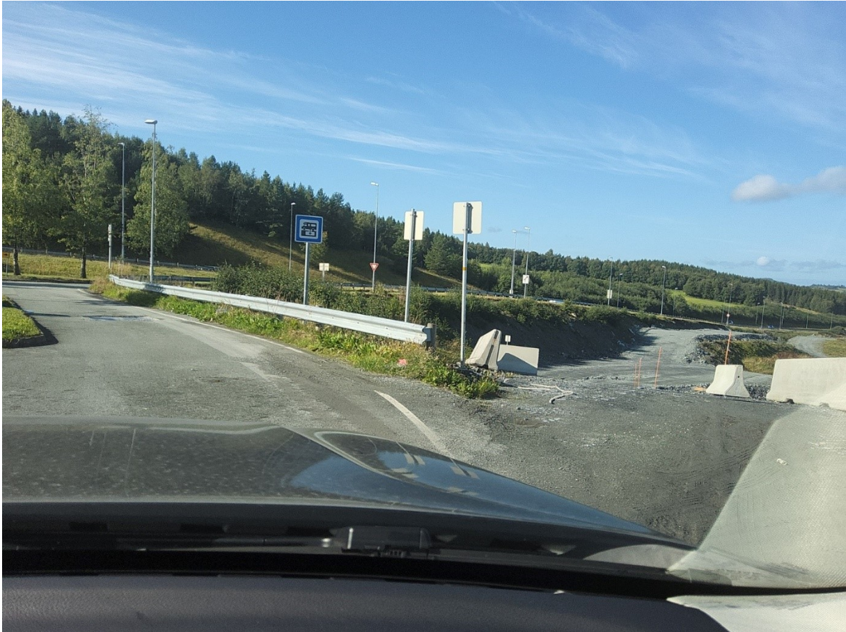
Bilde 1: Manglende endeavslutning på rekkverk og påkjøringsfarlige objekt i sikkerhetssonen. Ranheim - Værnes (Kilde: Vegtilsynet 06.09.2023).
