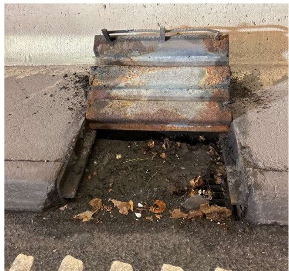
Bilde 1: Et bilde av en tett avløpssluk i Festningstunnelen
