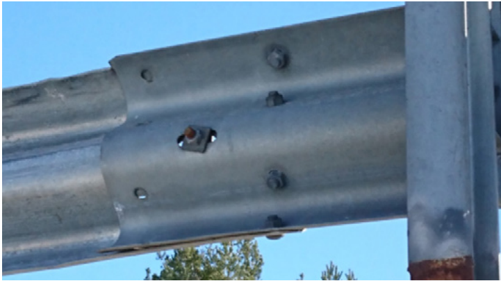
Bilete 1: Manglande boltar, ved bru
