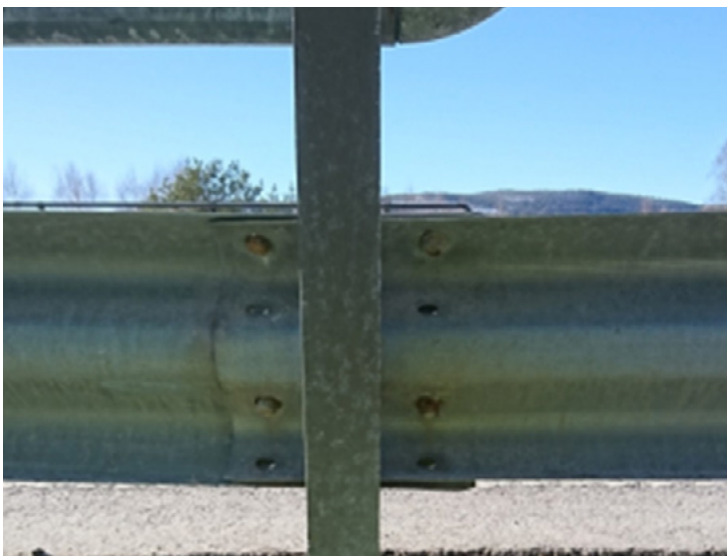
Bilete 2: Manglande boltar i overgang til bru
